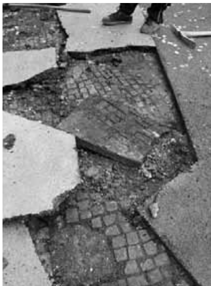
Obr. 110. Bourání asfaltového koberce přelitého přes chodníkovou mozaiku. Tento koberec lze často jednoduše odstranit.
