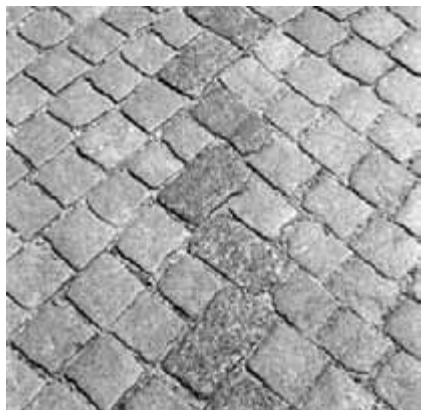
Obr. 50. Dlažba vozovky z drobných kostek I. třídy, sestavená ze zalomených řad, střední linie „vazáků“ je odlišena barevností horniny.
