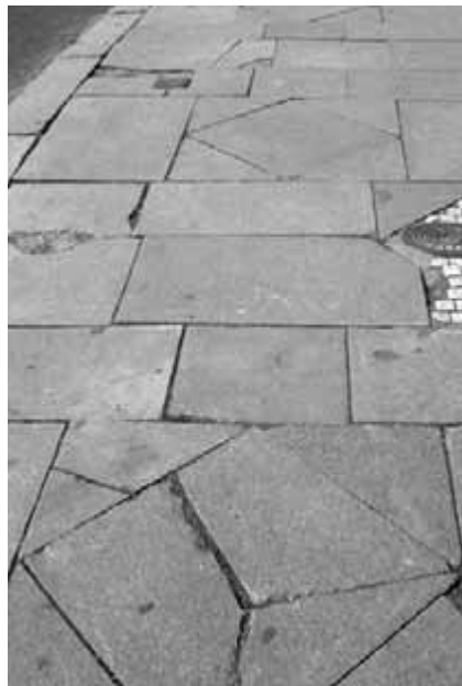
Obr. 35. Nevhodné zacházení s cenným materiálem. Při zřizování bezbariérového přechodu a výkopu byla brutálně poškozena atypická dlažba ze žulových desek, skládaná do vzoru.
