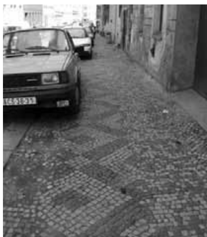
Obr. 78. Původní dvoubarevná chodníková mozaika, poruchy v levé části dlažby jsou způsobeny parkujícími vozidly, poruchy v pravé části jsou zapříčiněny výkopy při ukládání inženýrských sítí.
