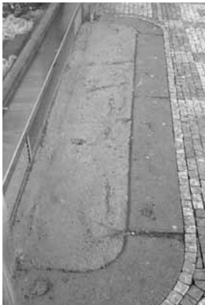
Obr. 34. Zrušený anglický dvorek. V ploše chodníku zůstaly zachovány žulové obrubníky.
