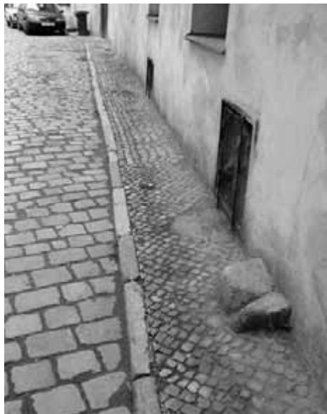
Obr. 92. Řádková dlažba vozovky z opracovaných křemencových krychlí a hranolů s původní vápencovou obrubou, vzniklá v době zavádění zvýšených chodníků. Na fotografii je patrná původní, ručně vyráběná chodníková mozaika a torzo odrazníkového kamene, který byl funkční do doby zavedení zvýšených chodníků.
