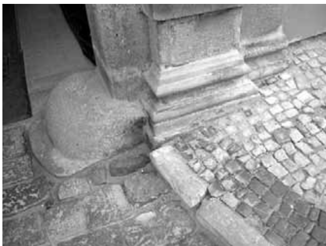
Obr. 73. Důsledkem zvyšování úrovně chodníků a vozovek je nežádoucí překryvání patek portálů (na fotografii), stupňů, spodní hrany sklepních oken a podobných prvků i zvyšování vlhkosti zdiva.
