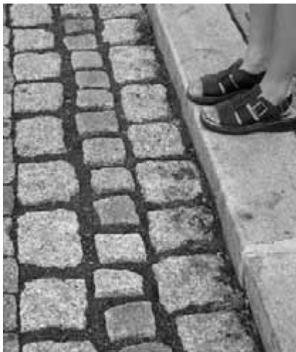
Obr. 113. Široké spáry jsou příčinou uvolňování kostek z podkladu. Kamenná drť umožňuje zatékání dešťové vody do spodní konstrukce.
